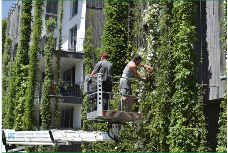
Pflegegang mithilfe eines Hubsteigers
